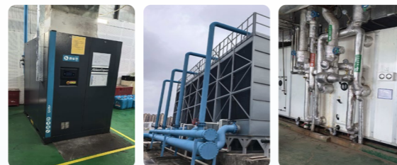
节能技改项目现场图
