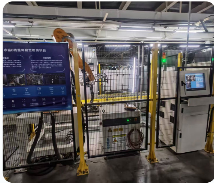
冰箱B线整体视觉检测项目现场图
